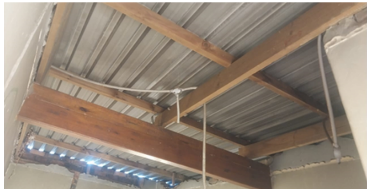
Electrical wiring stolen.
